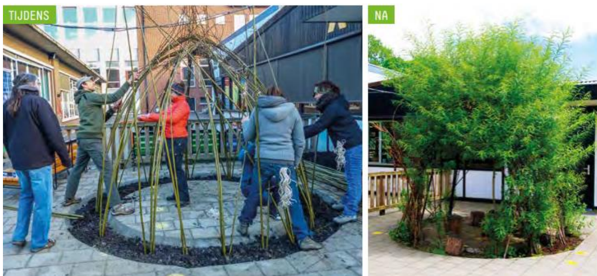
Figuur 40: De bouw van een wilgenhut op de Vrije kleuterschool Mater Dei in Leuven (bron: inspiratiegids voor groene speelplaatsen van de provincie Vlaams-Brabant)
